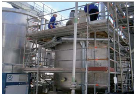
Behälteraufstellung für die Schwefeleinmischstation
