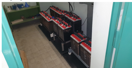
Batterieladestationen mit techn. Lüftungsanlage
