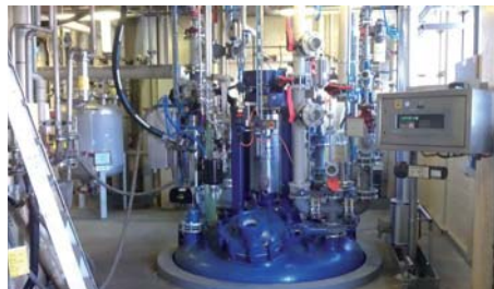
Der neu installierte 6,3 m 3 Stahlmaille-Reaktor
