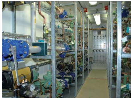
LT-Container mit Gasmischanlage zur Erzeugung eines Sauerstoffgemisches
