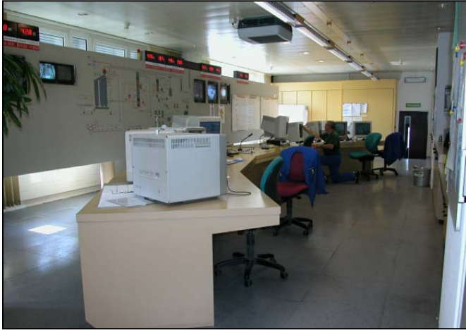
Leitstand der bestehenden Anlage „ALV2“
